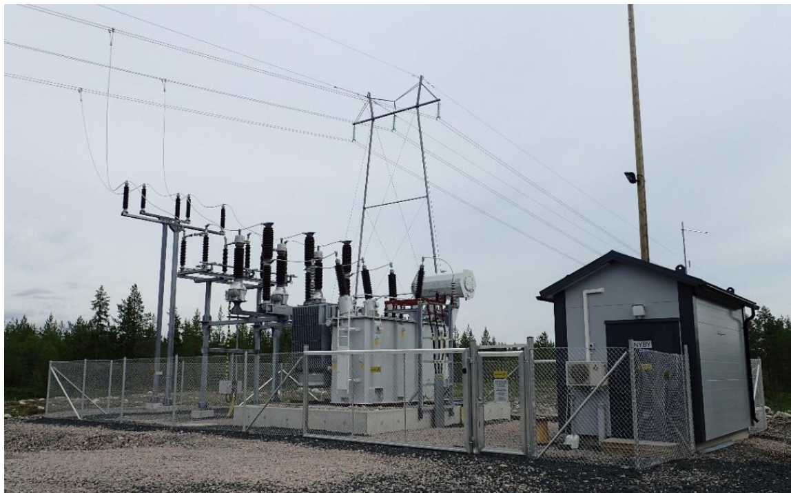
Kuva 2-14 Esimerkki tuulivoimapuiston sähköasemasta.
