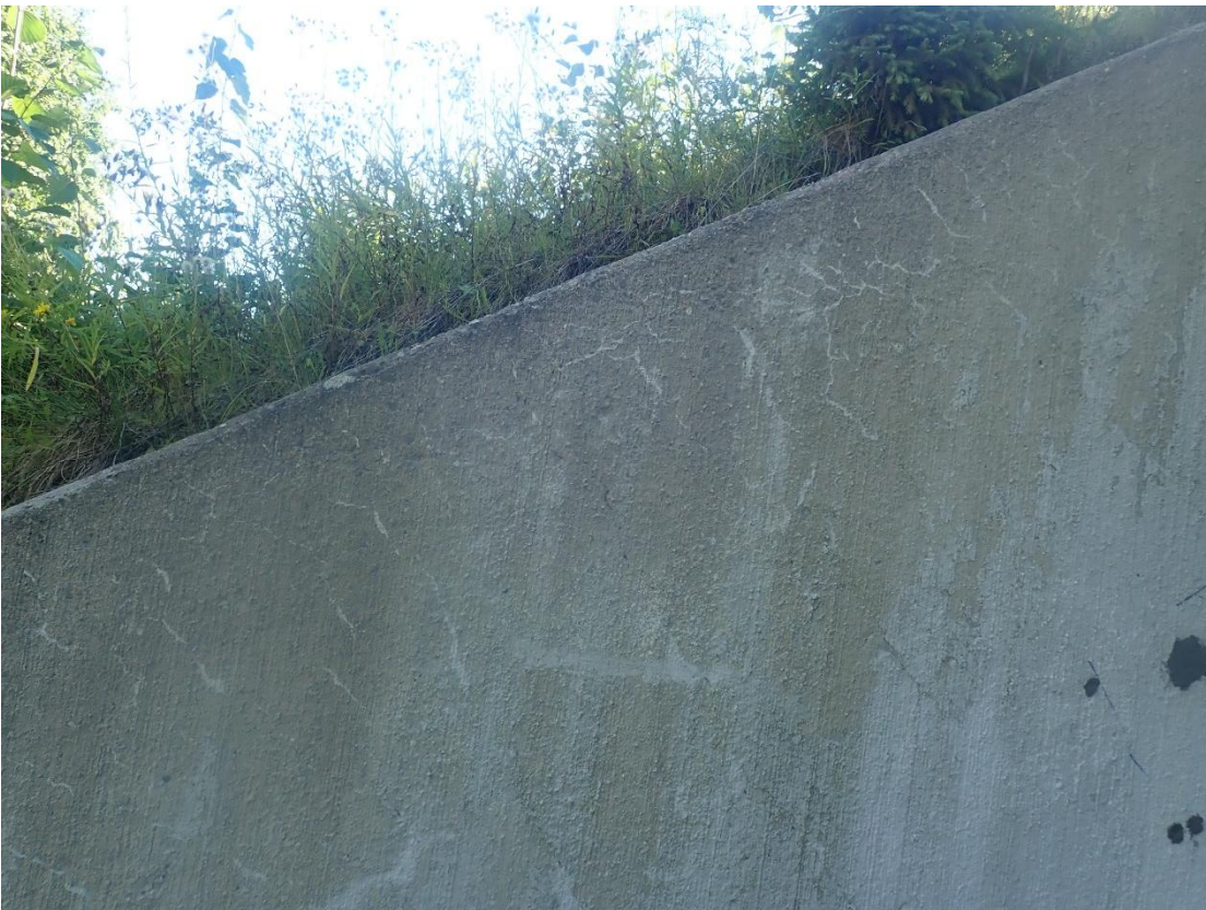
Kuva 6. Siipimuurin 1 oikea halkeilua
