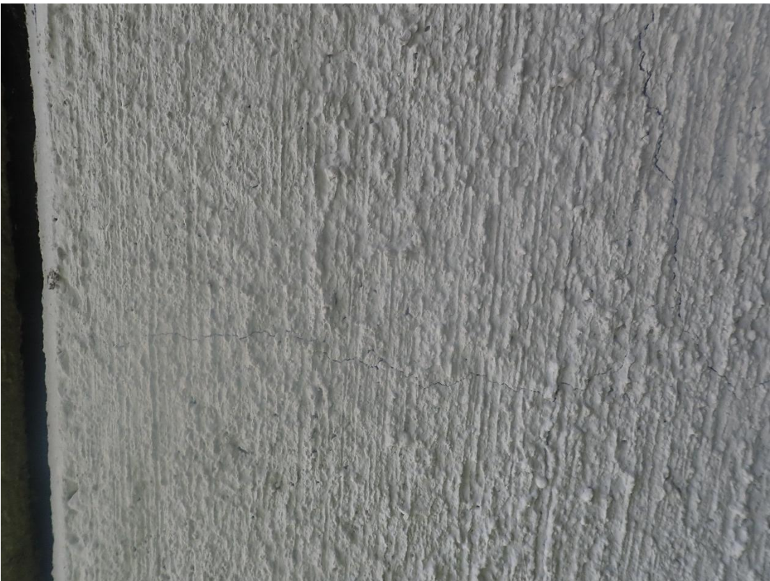
Kuva 4. Etumuurin 2 toisen elementin vasemmalta verkkomaista halkeilua
