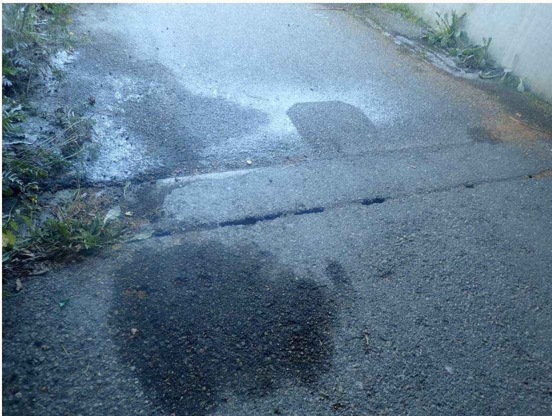
Kuva 11. Alittavan väylän päällysteen purkaumaa
