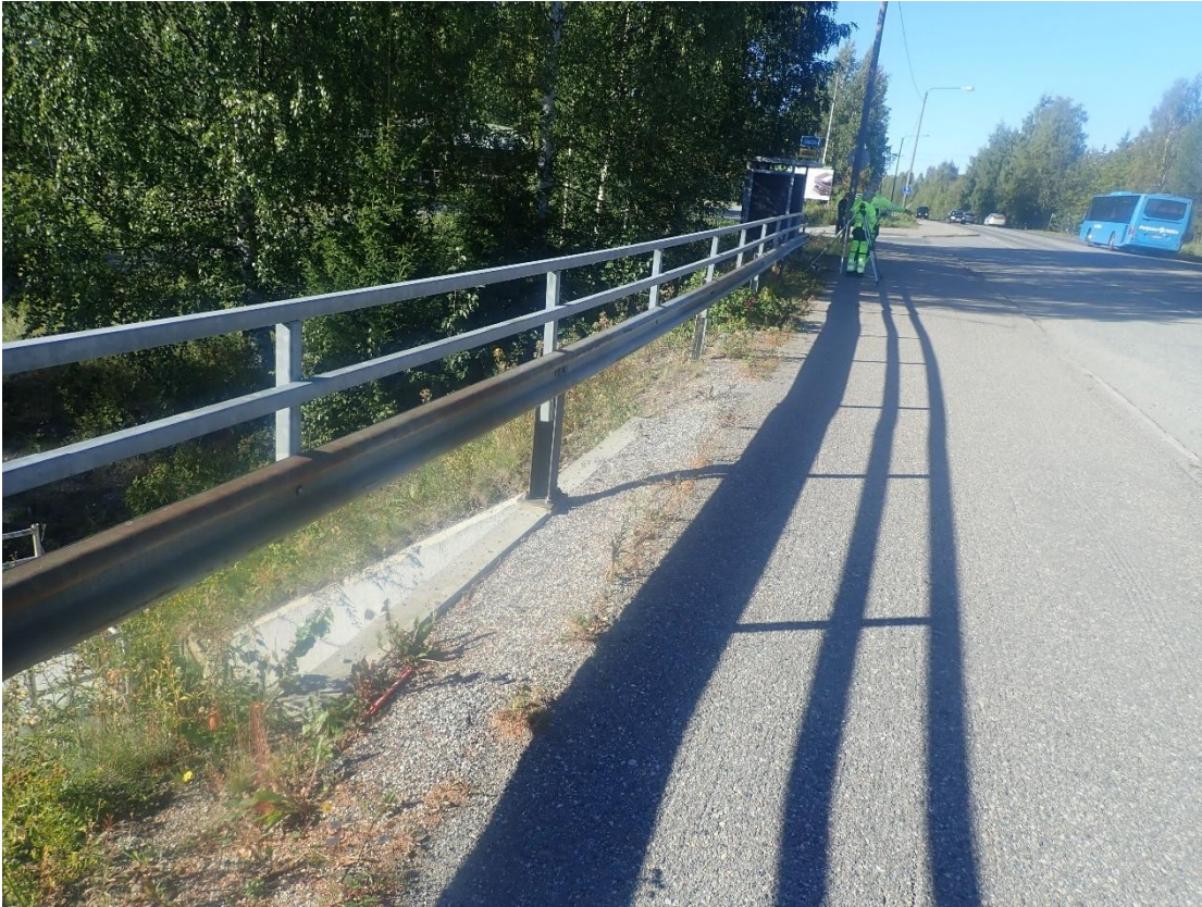
Kuva 9. Vasemman puolen kaiteesta puuttuu väljohde alhaalta sekä väärä kaideyyppi
