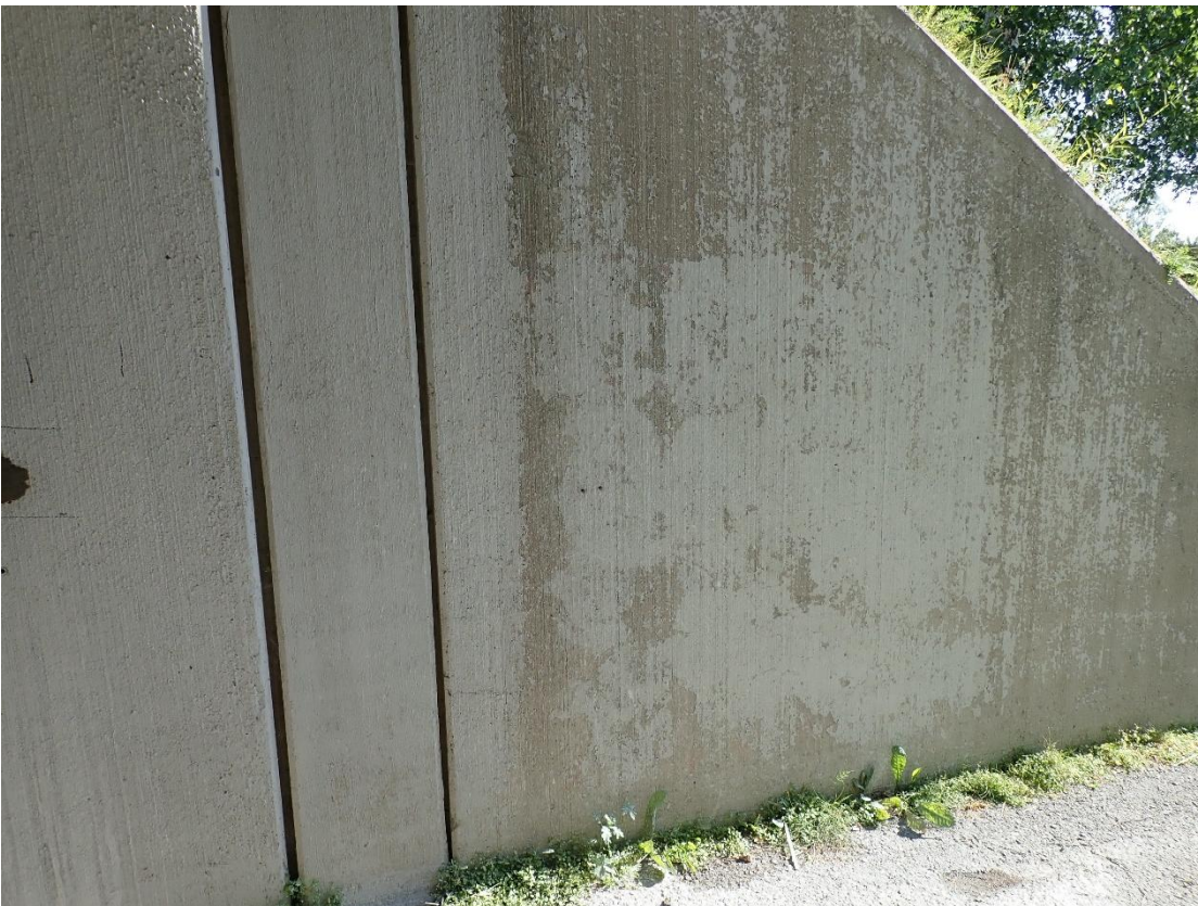
Kuva 3. Siipimuurien pinnoite on hilseillyt.
