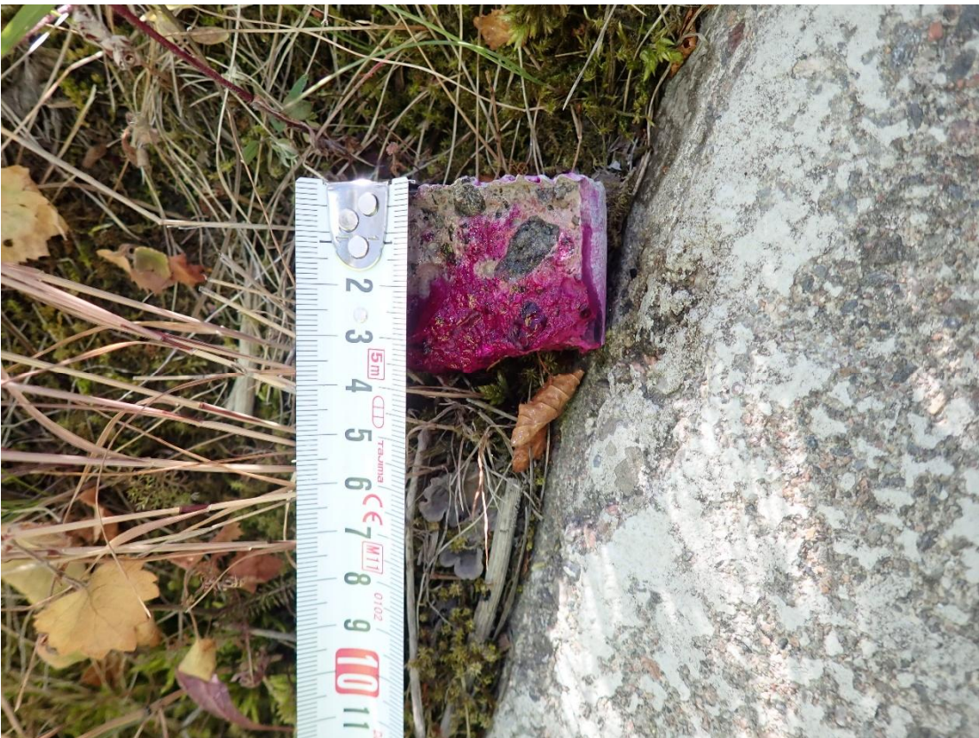
Kuva 15. Etumuurien karbonatisoituminen on edennyt paikoin 20 mm.
