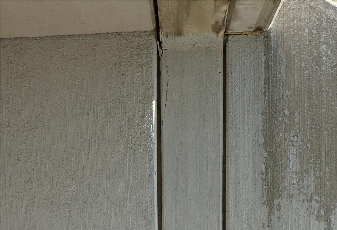
Kuva 4. Etumuureissa on ruostumisesta aiheutunutta halkeilua.
