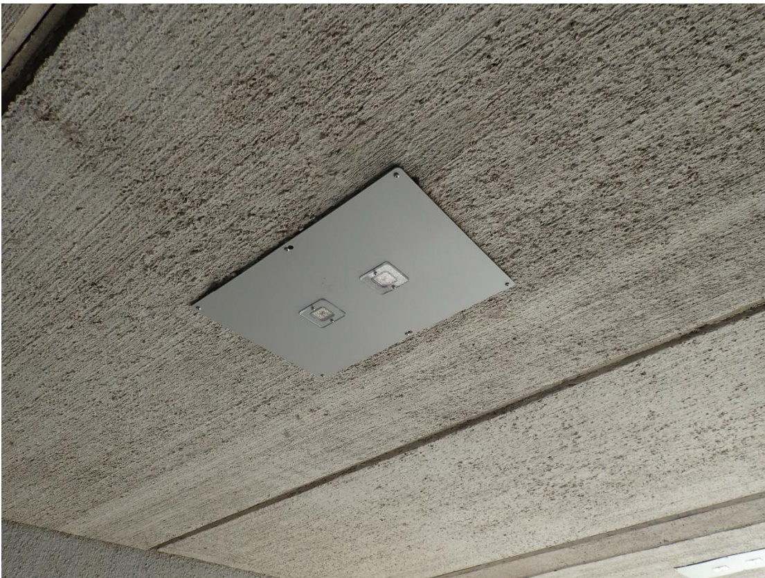
Kuva 13. Sillassa on 4 kpl led valaisimia. Valaisimet ovat kunnossa.
