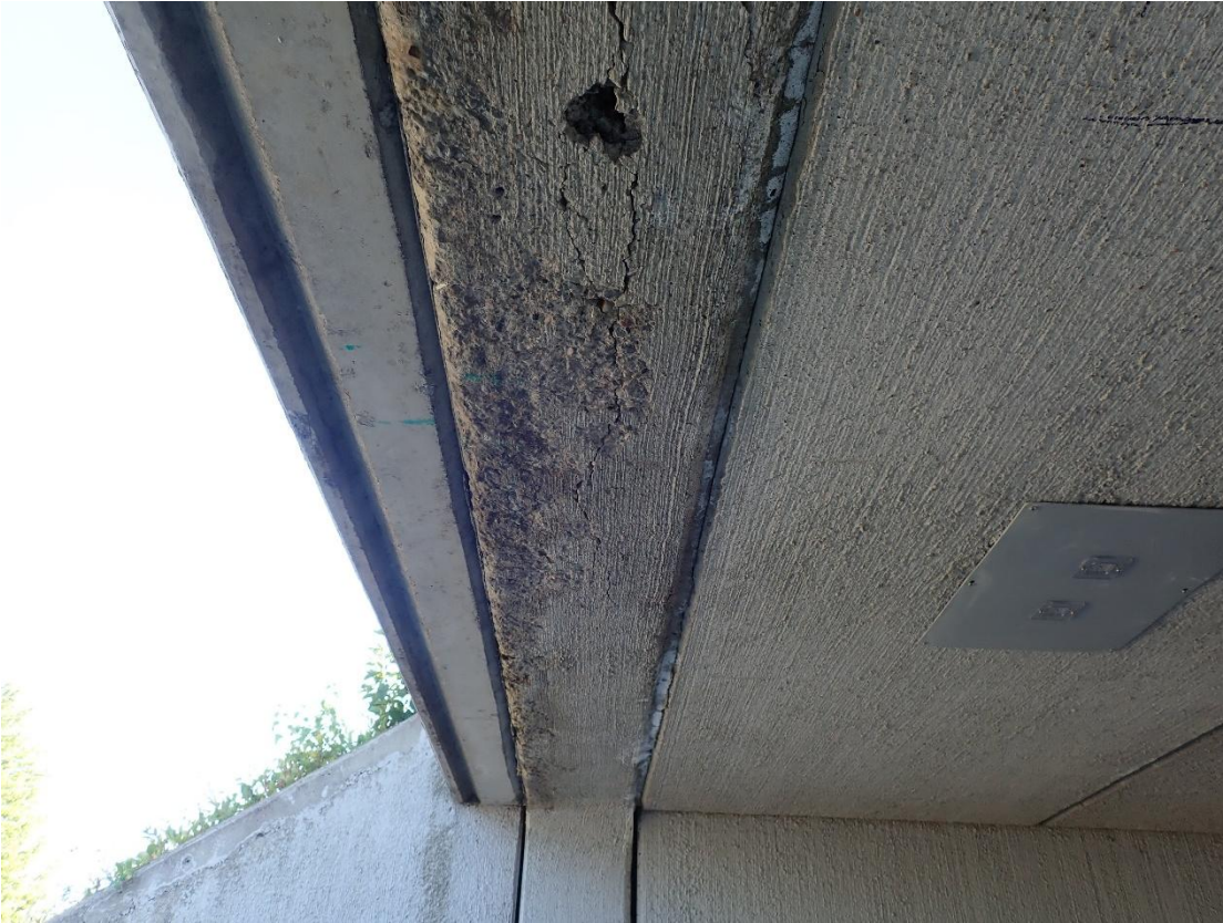
Kuva 8. Kannen alapinnassa on reunojen kehäelementeissä vakavaa rapautumaa ja ruostumista. Pituussuuntaisen halkeaman takaa paljastui pahoin ruostunut teräs.
