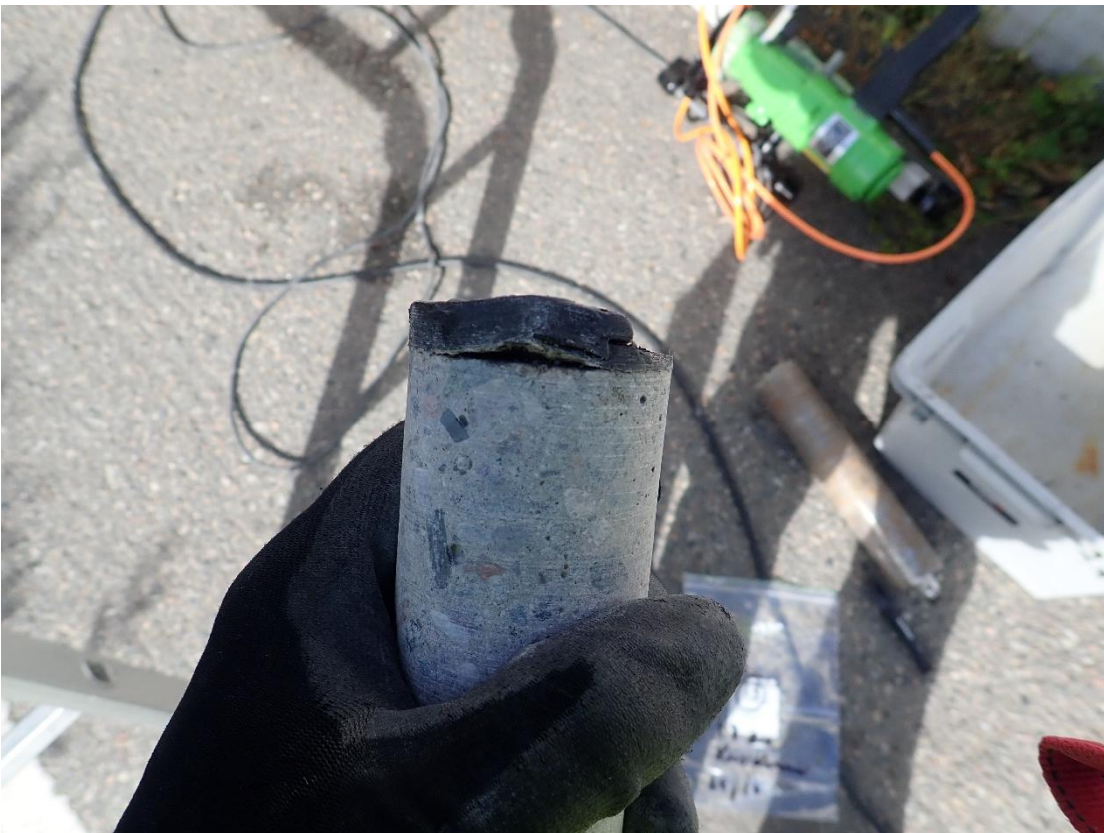
Kuva 11. Eristeen lasikuitukangas on hajonnut ja eriste irtosi helposti kannen yläpinnasta. Laboratorion arvio eristeen kunnosta oli heikko.
