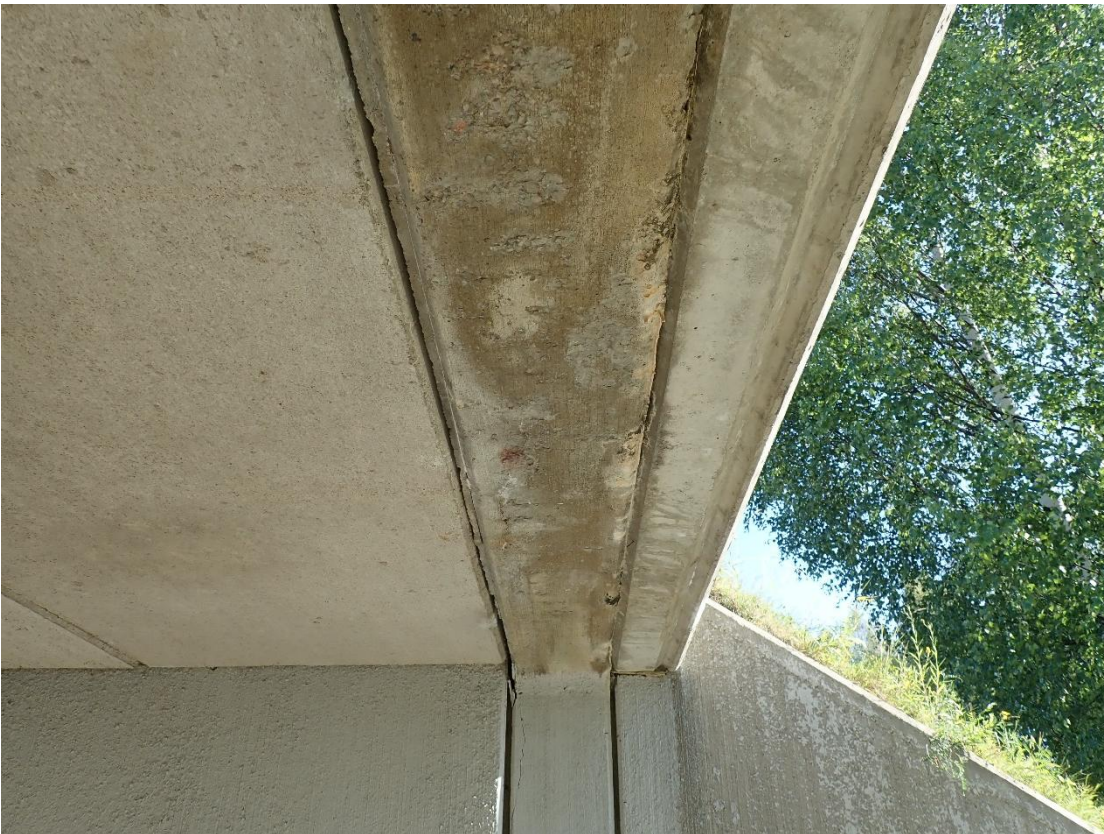
Kuva 9. Elementtien saumoista on vakavaa vesivuotoa sillan molemmissa reunoissa.
