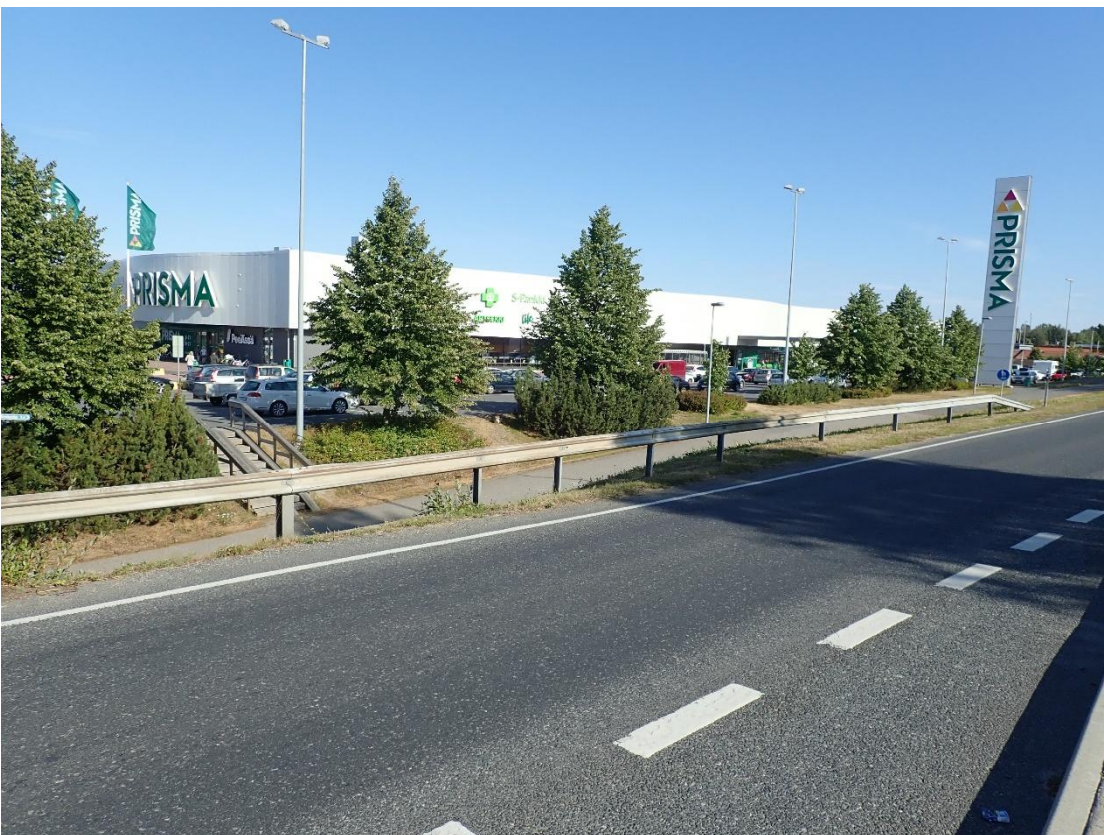
Kuva 7. Reunapalkit ovat matalaa tyyppiä (vesi pääsee valumaan tieltä alittavalle väylälle ja reunaelementin sivu- ja alapinnalle). Sillan kaiteet ovat liian matalat, siirtymärakenteet ovat puutteelliset ja kaiteen suojaverkko puuttuu.
