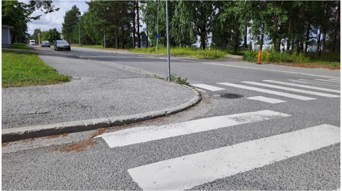
Kuva 5. Joukolankadun ja Kulmakadun liittymässä jalkakäytävän reunatuki on liian korkea suojateiden päässä. Lisäksi reunatukilinja on kaareva, mikä vaikeuttaa näkörajoitteisen liikkumista.
