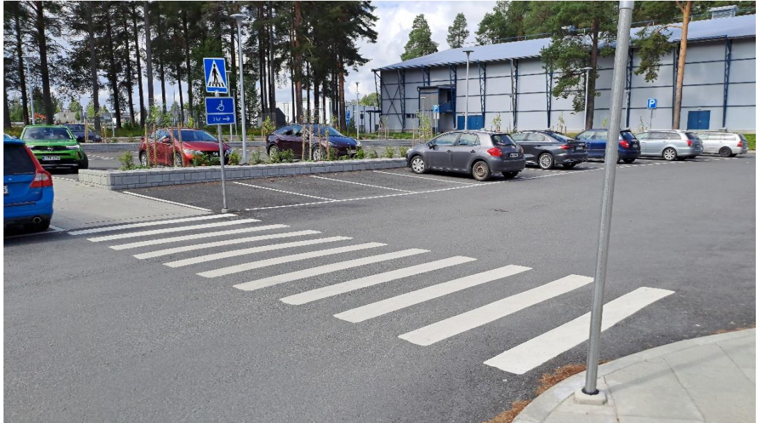
Kuva 7. Uimahallin kolme uutta liikuntaesteisten pysäköintipaikkaa eivät täytä liikuntaesteisten pysäköintipaikkojen leveysvaatimuksia. Lisäksi pysäköintipaikkoja osoittavat liikennemerkkit aiheuttavat törmäysriskin.
