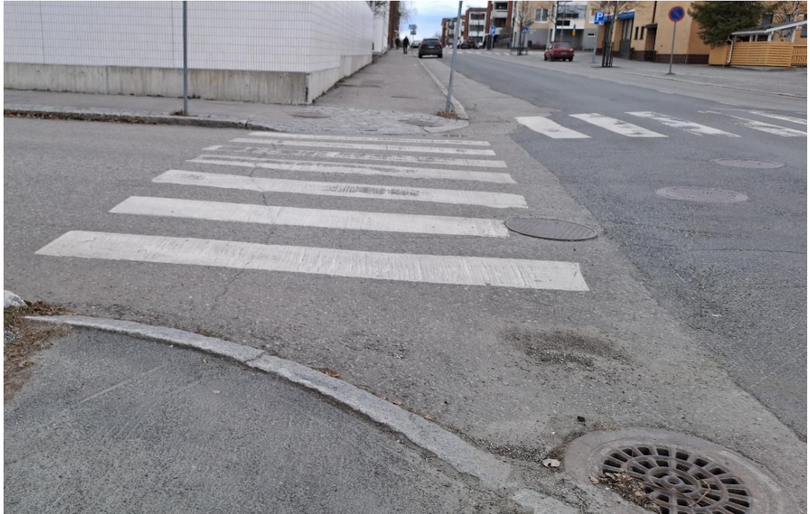
Kuva 23. Epätasaiset kulkupinnat jalkakäytävällä vaikeuttavat erityisesti pyörätuolilla siirtymistä suojatieltä jalkakäytävälle. Kuva Riistakadun ja Kirkkopuistonkadun liittymästä.
