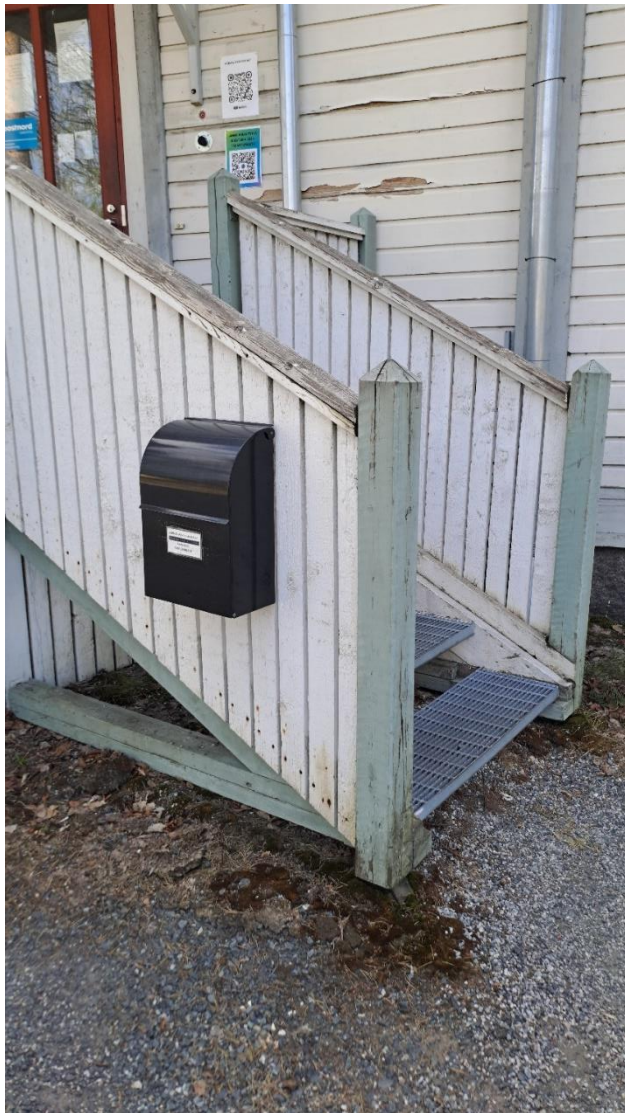
Kuva 40. Monista portaista tai luiskista puuttuu kunnolliset käsijohteet. Käsijohteet ovat tarpeellisia tasapainon ylläpitämiseksi. Kuva Lapinlahdelta.
