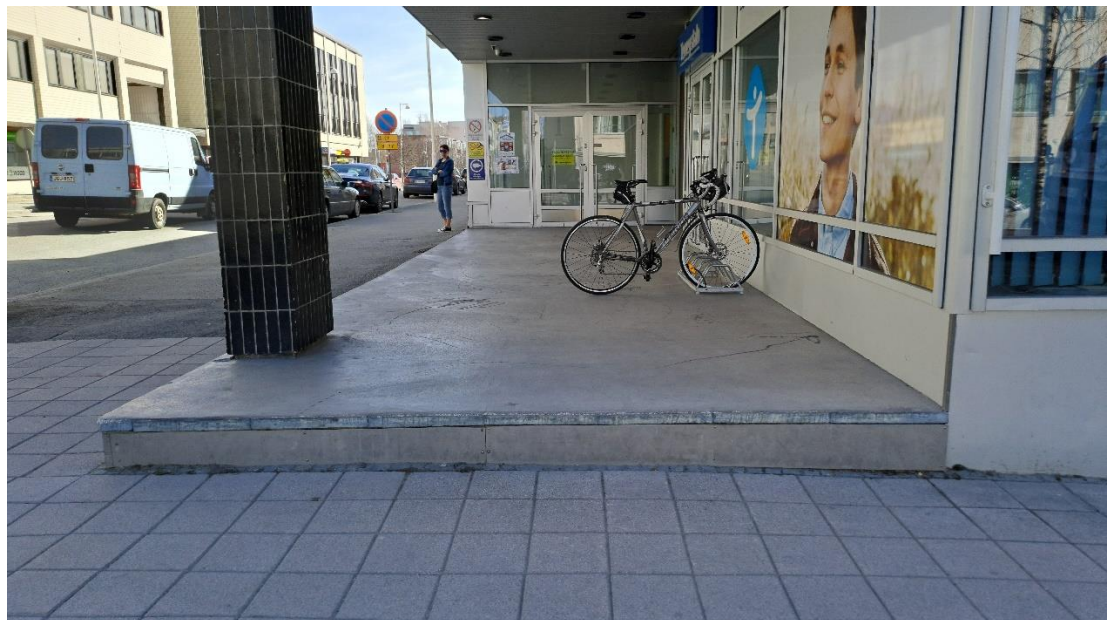
Kuva 12. Terveystalon edustalla on tasanne, jonka Pohjolankadun puoleinen reuna on korkea. Heikko kontrasti tasanteen ja jalankulku- ja pyöräilyväylän välillä aiheuttaa putoamis- ja kompastumisriskin.
